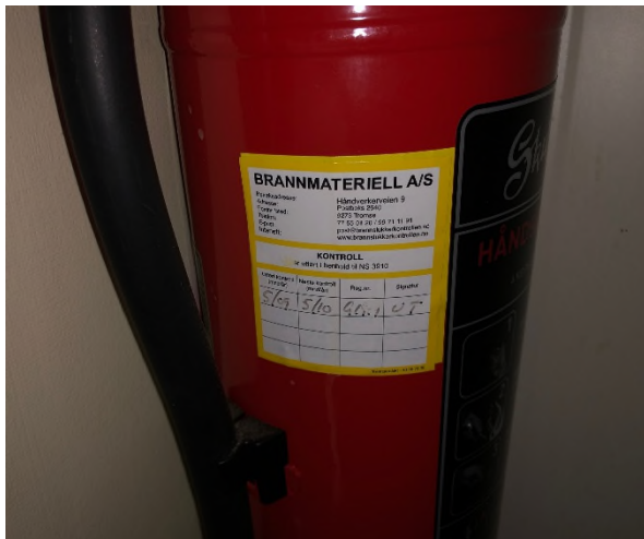
Bilde 9.4.1 – Kontroll av brannmateriell.
