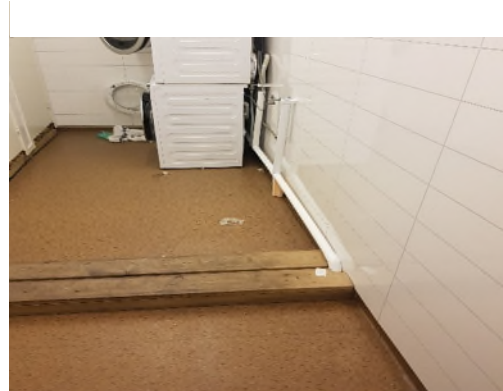
Figur 6: Avløps-ledninger fra vaskemaskiner
