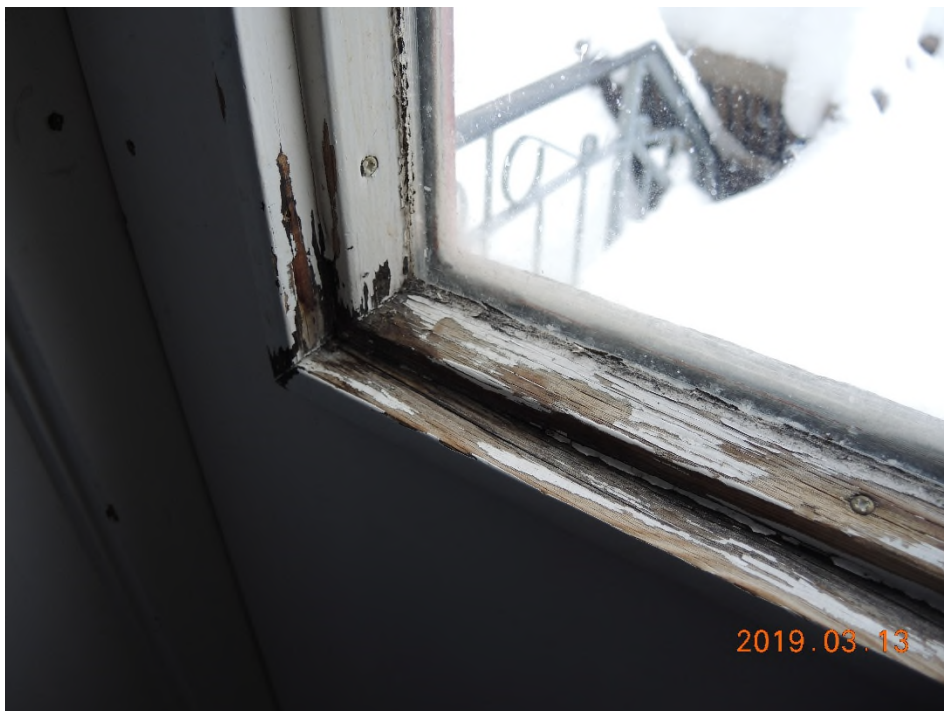
Bilde 8 – Nr. 71 – Balkongdør sør..
