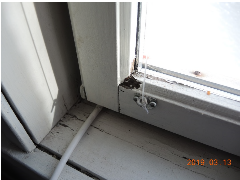
Bilde 6 – Hovedbygning -åpningsvindu kjeller, fasade øst.
