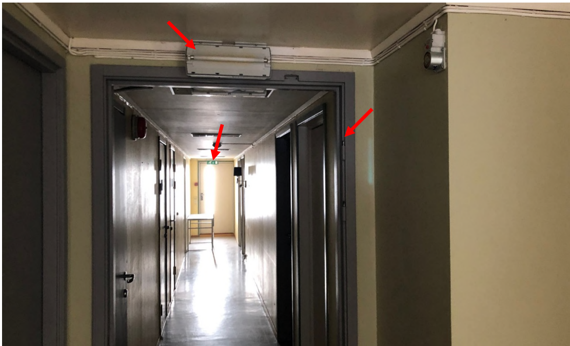
Bilde 9.2.1 – Dørblad og skilt mangler. Merket rømningsdør til det fri er ikke tilgjengelig og mangler dørvrider.
