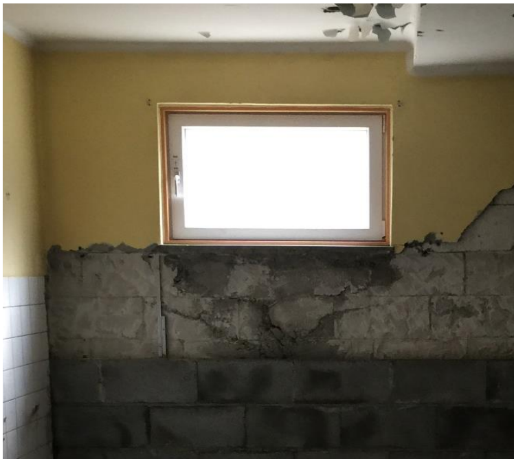
Figur 5-3 Typisk eksempel på støpekvaliteten- Bygg 7
